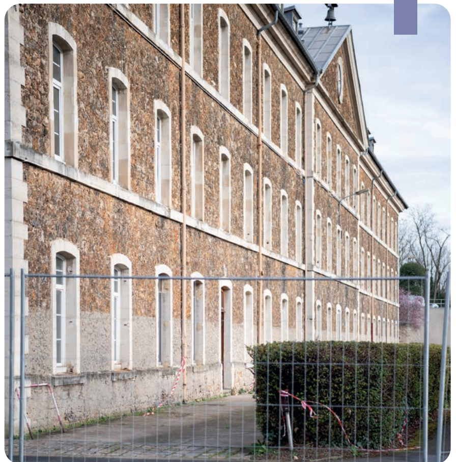
1 er mars 2024, Fort d'Ivry-sur-Seine (Val-de-Marne) Extérieur du bâtiment Vie en cours de rénovation © Malo Harmant/ECPAD/Défense
